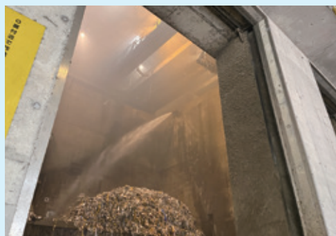
可燃ごみピット消火活動の様子
