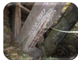
主桁の鉄筋露出
