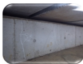
橋台のひびわれ
