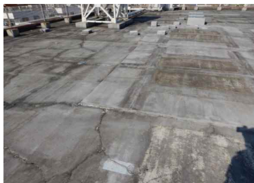
防水層の著しい劣化、スラブ露出（D）
