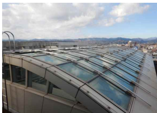
トップライト漏水有り（C）
