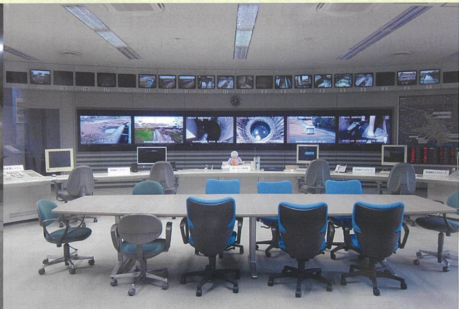
20台のカメラでの集中監視 5本ある立坑からの状況を見る 令和5年にも数回浸水防止に寄与
