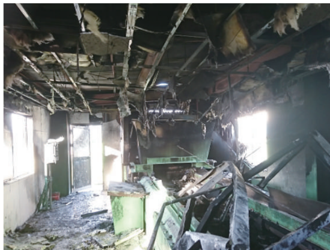
充電電池の発火事故が原因でリサイクル処理施設が焼けてしまった事例
