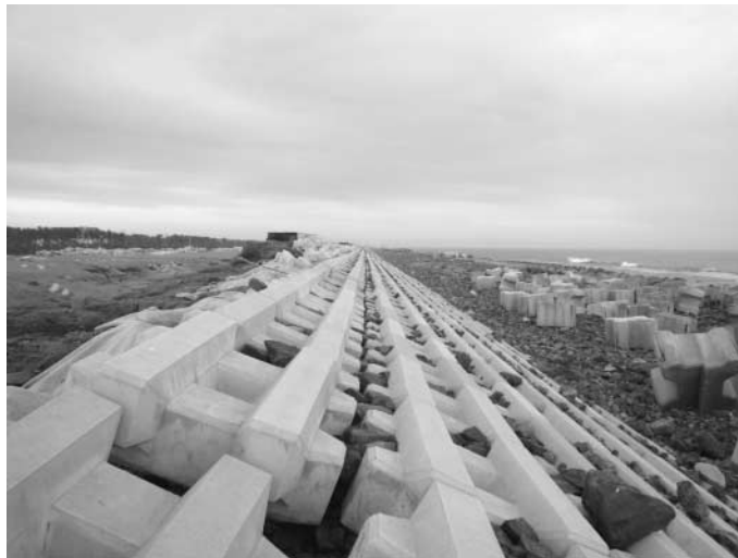
津波で決壊した堤防（宮城県名取市）
